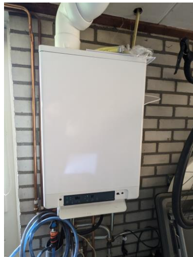
Foto 4: Huidige cv-ketel en aansluitingen
