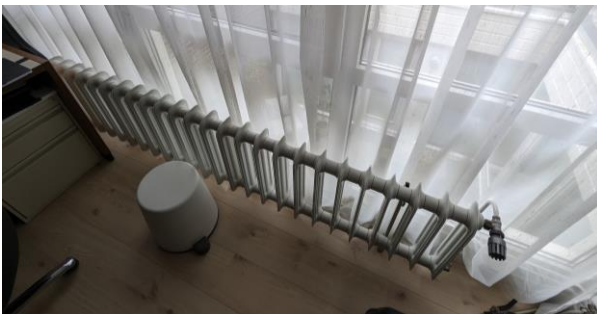
Foto 2: Enkele kolom radiatoren aanwezig
