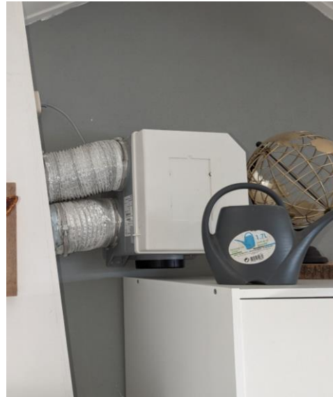
Foto 4: Mechanische ventilatiebox voor de badkamer.
