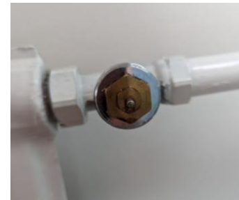
Foto 6: Niet regelbare radiatorkraan. Ongeschikt voor waterzijdig inregelen
