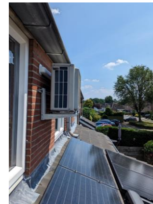
Foto 6: Airco buitenunit aan de gevel
